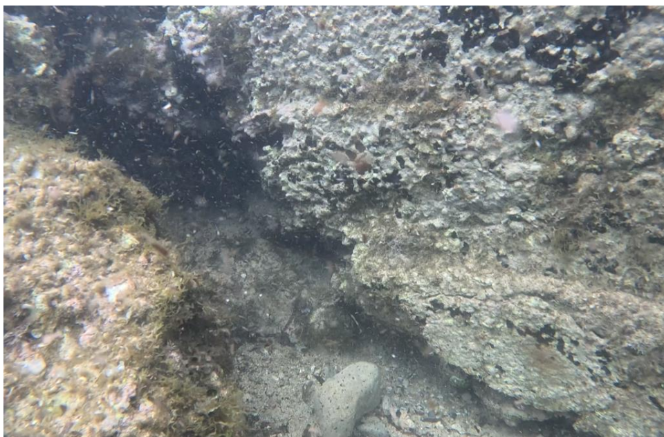
Slika 8 – Podlokanje obalnog zida između stacionaža 0+022,81 m do 0+024,60 m
