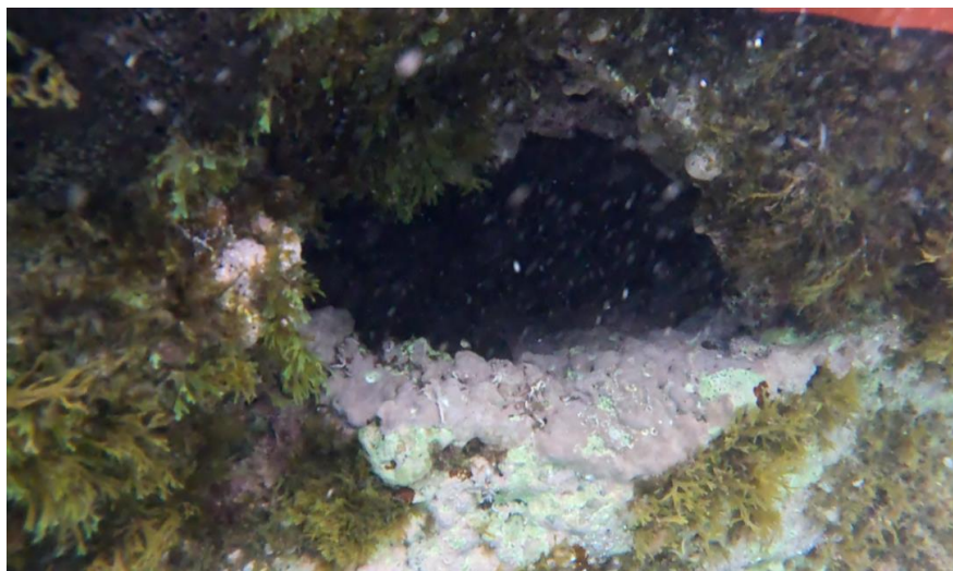
Slika 5 – Oštećenje obalnog zida između stacionaža 0+020,66 m do 0+020,96 m
