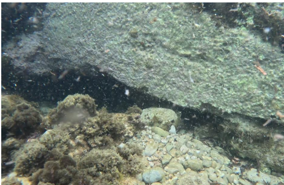
Slika 3 – Podlokavanje obalnog zida između stacionaža 0+013,64 m i 0+014,44 m
