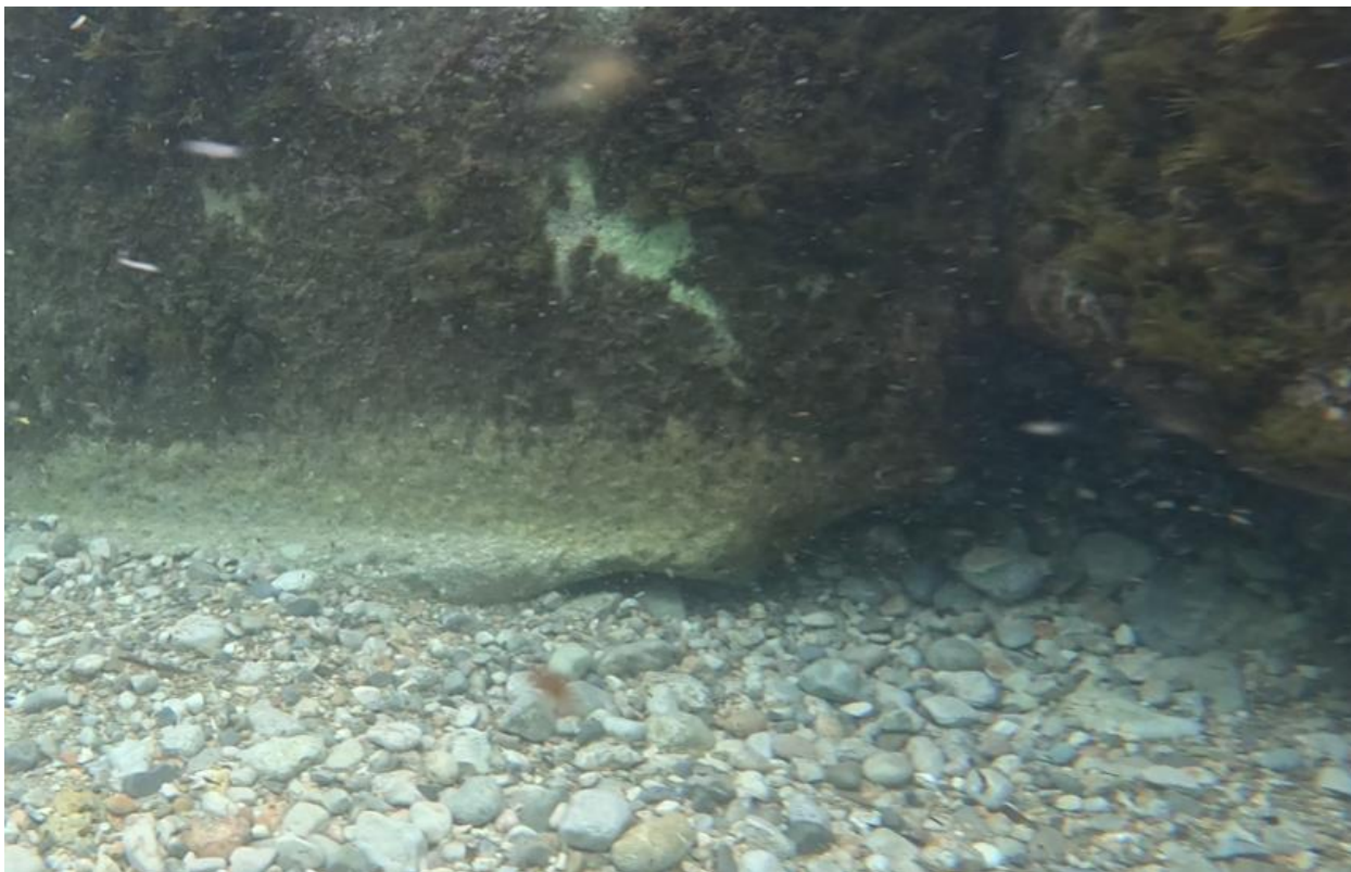
Slika 6 – Podlokanje obalnog zida između stacionaža 0+022,26 m i 0+022,81 m
