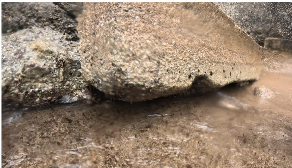
Slika 12 – Podlokanje obalnog zida između stacionaža 0+022,26 m i 0+022,81 m
