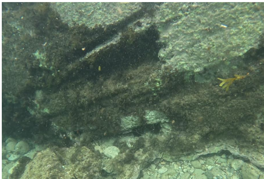
Slika 4 – Oštećenje obalnog zida između stacionaža 0+018,51 m do 0+019,06 m
