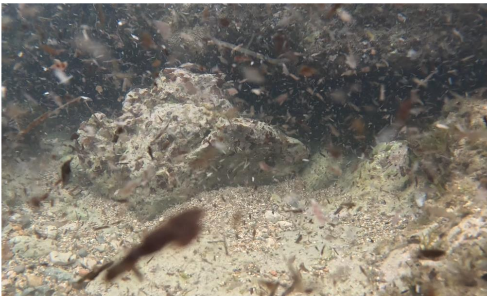
Slika 11 – Podlokavanje obalnog zida između stacionaža 0+033,43 m do 0+034,63 m
