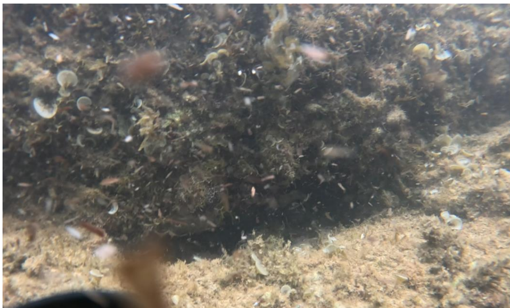
Slika 10 – Oštećenje obalnog zida između stacionaža 0+020,66 m do 0+020,96 m
